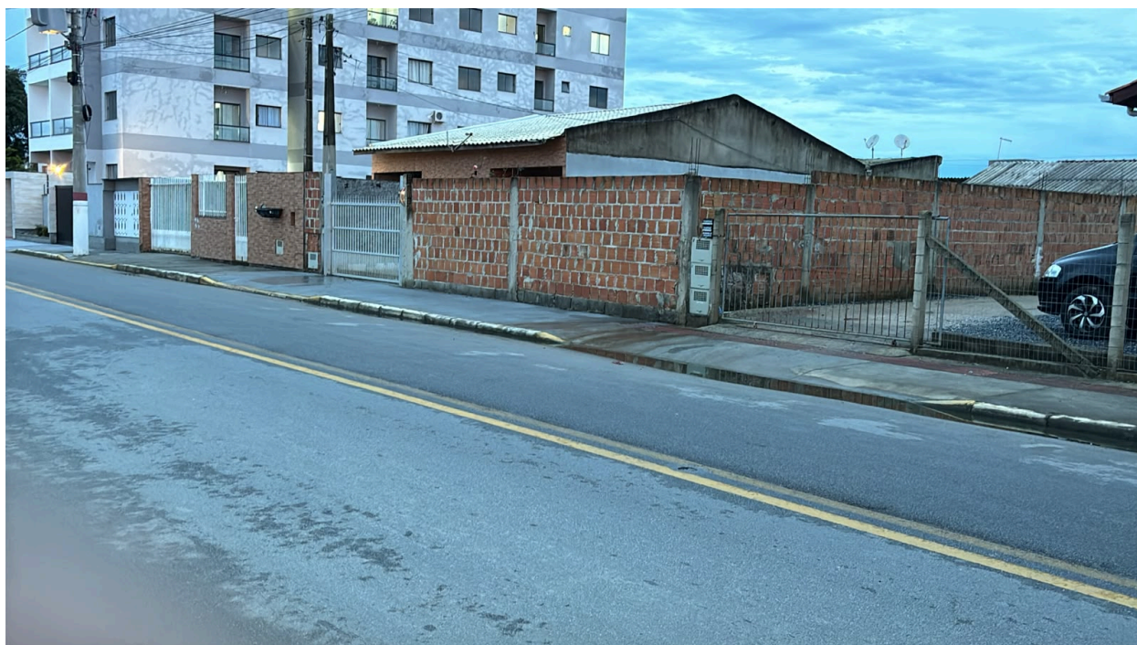
Registro fotográfico do local: (Rua Henrique Boiteux, Bairro da Praça), evidenciando o acúmulo de efluente/água e o refluxo junto ao meio-fio.
